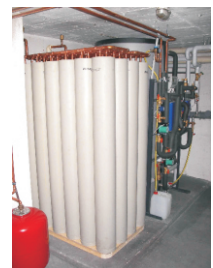
Réservoir avec 24 cellules thermiques.
